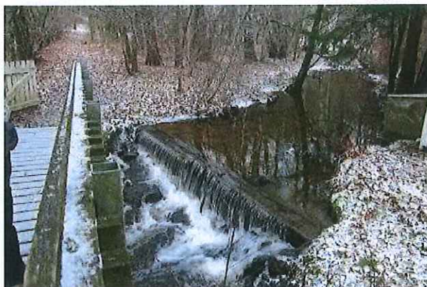
Det gamla brofundamentet utgjorde ett vandringshinder före åtgärden.
